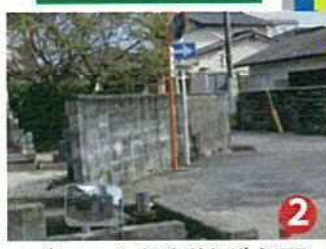
ブロック塀倒壊が心配
