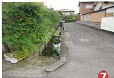
ガードレールがない
