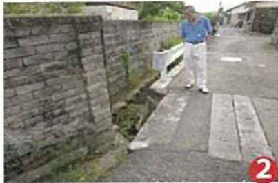
ガードレールがなく危険
