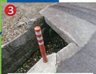
ガードレールなく危険
