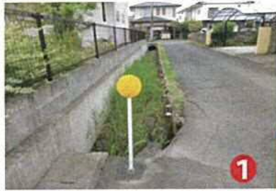
ガードレールがなく危険
